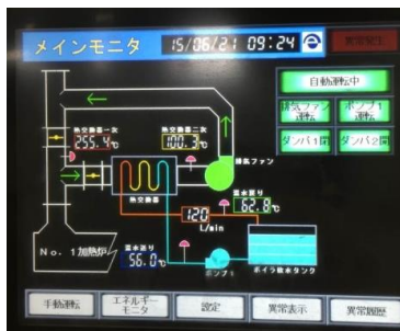
▲排熱回収状況はモニターで一目瞭然
