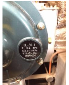
LNG用圧力調節計⇒
