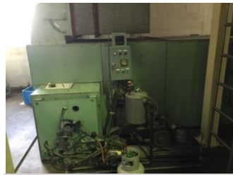
施工前 (オイルバーナ)
