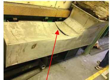
ダクト鋼板が熱の為に變形 熱風漏れ発生！
